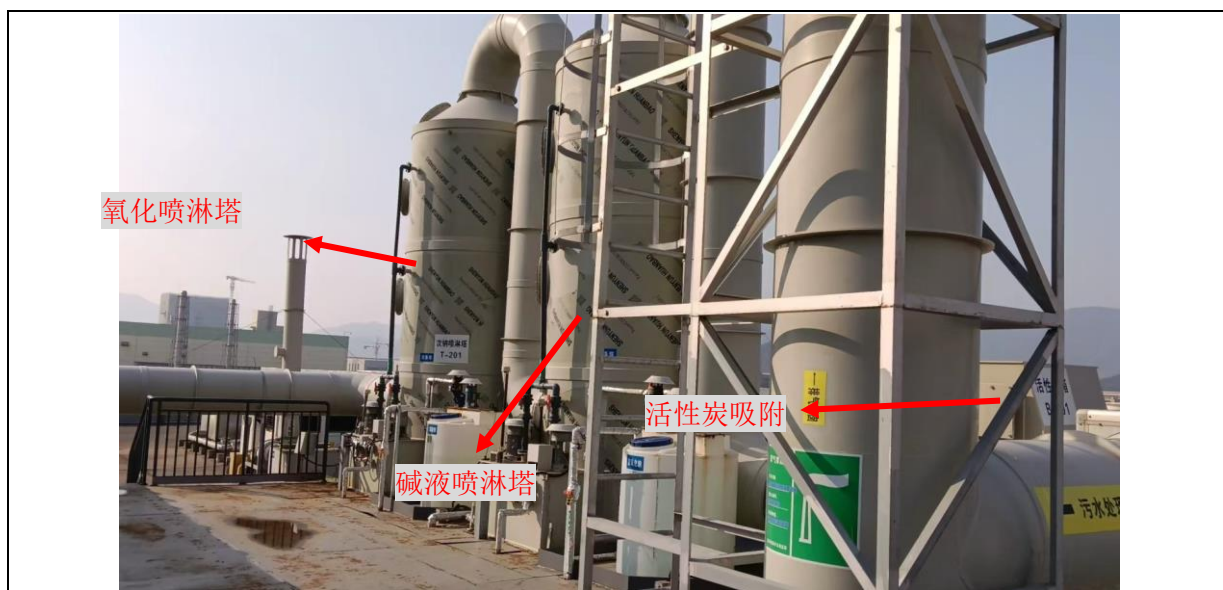
污水处理站废气处理设施
