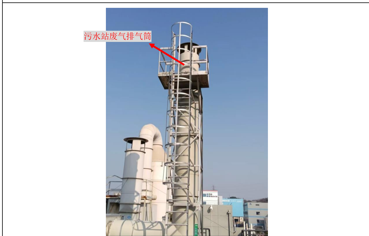
污水站废气排气筒
